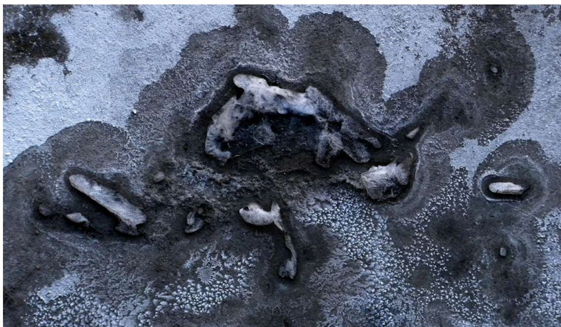
Figure 3: effet du sel d'épandage sur les routes : le sel sèche et s'accumule
